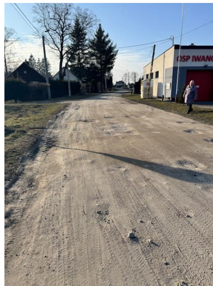
Rysunek 28. Braki w infrastrukturze drogowej i pieszej – brak utwardzonych nawierzchni
